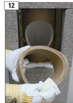
12 Rauchrohrstutzen mit feuchtem Schwamm säubern.
