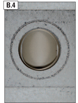
B.4 Ansicht durchbohrter Mantelstein und Schamotterrohr.
