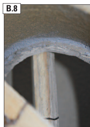
B.8 ACHTUNG: An der Oberseite zum Rauchrohrstutzen ist immer eine Abtropfkante auszubilden!
