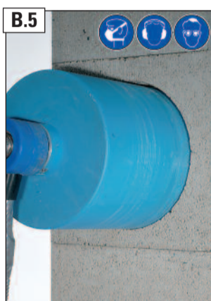
B.5 Mantelsteinöffnung jetzt mit größerer Bohrkronen vollständig aufbohren. WICHTIG: Schamotterrohr dabei nicht beschädigen oder anbohren!
