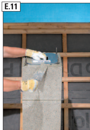
E.11 Mörtelbett MG (M5) IIa bzw. MG (M2,5) II mit Versetzschablone auftragen.
