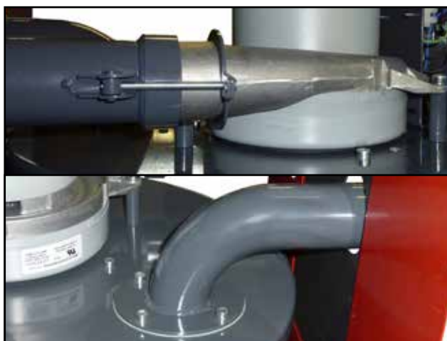
Anschluss der Ausblasleitung zum Lüfter
